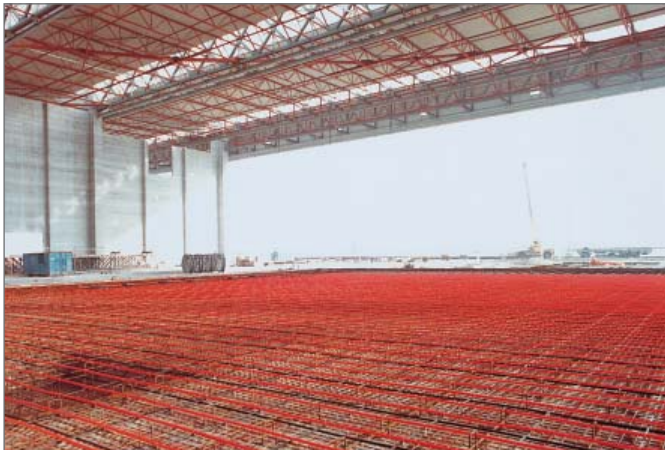
Рис. 9-1 Напольное отопление в промышленном цехе
